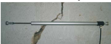
Fissurometer zur Rissüberwachung
