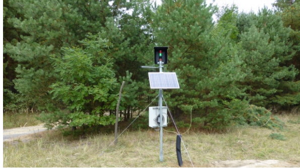
Datenlogger mit Solarversorgung, GSM-Kommunikation und optischer Alarmierung
